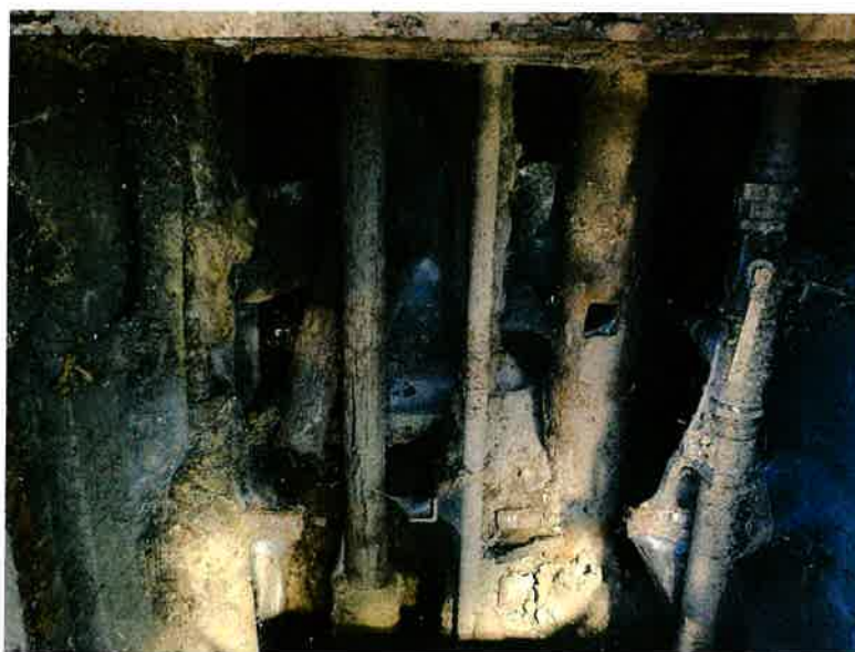
Technológia csatorna a benne futó vezetékekkel
